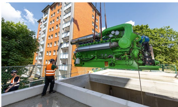
Umbau in der Stellinger Linse: Hier „flog“ der Motor für das Biomethan-BHKW in die Energiezentrale, die Solarthermieanlagen folgten.
